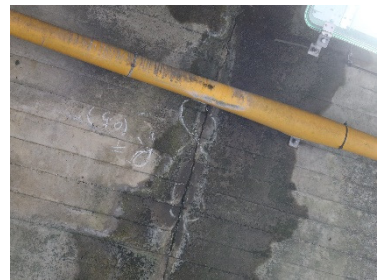
写真-5 漏水（天端部）
