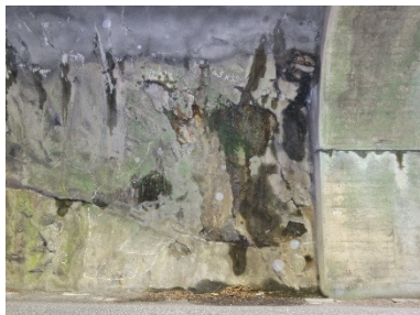
写真-3 うき・ひび割れ・剥離
