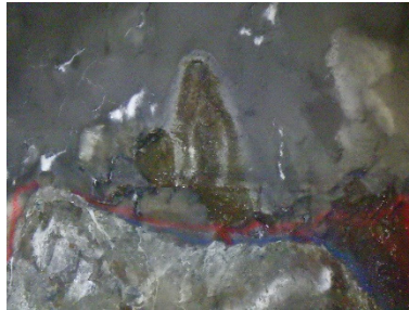
写真-4 漏水（側壁部）
